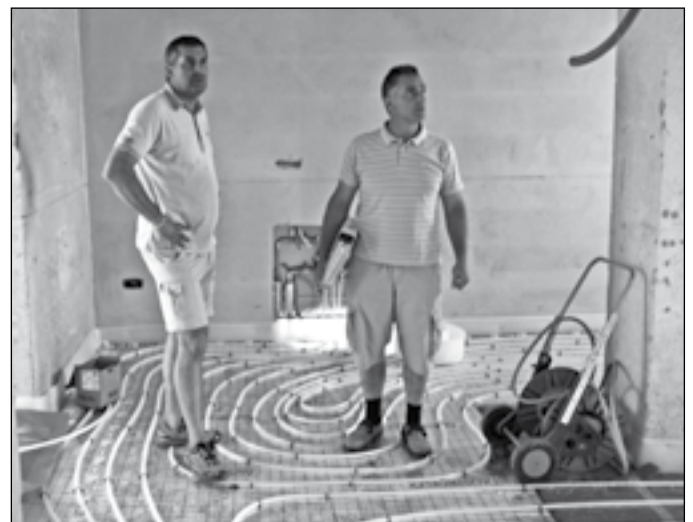
Fußbodenheizung im Kindergartenbereich in der VS Kirchbach
